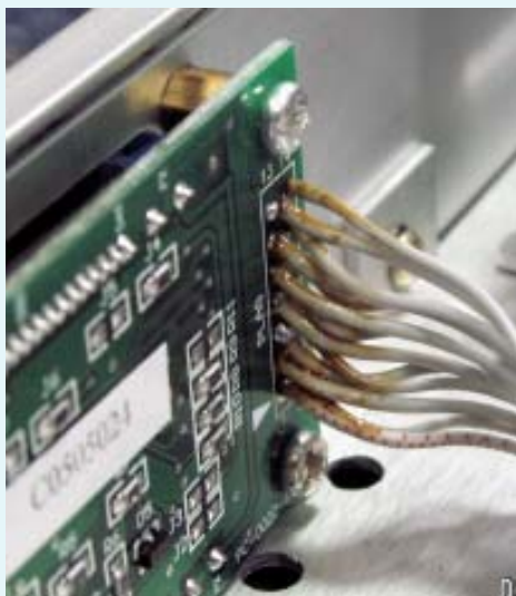
Фото 4.3. Ленточный кабель имеет очень плохое качество пайки
