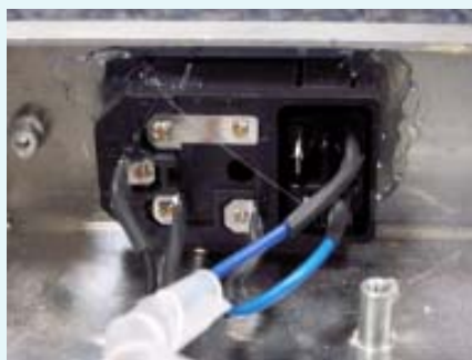
Фото 2.5. Приборная электророзетка зафиксирована с помощью клея (!!!).
